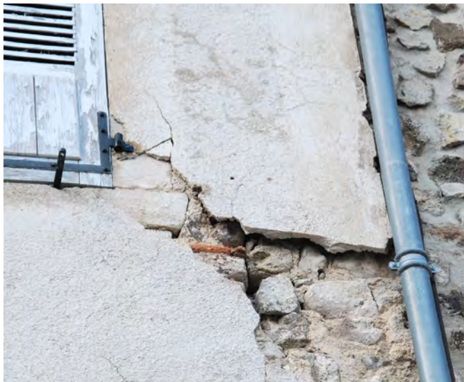
Couche d'enduit de quelques centimètres recouvrant la maçonnerie y compris les encadrements de baie en pierre de taille.
